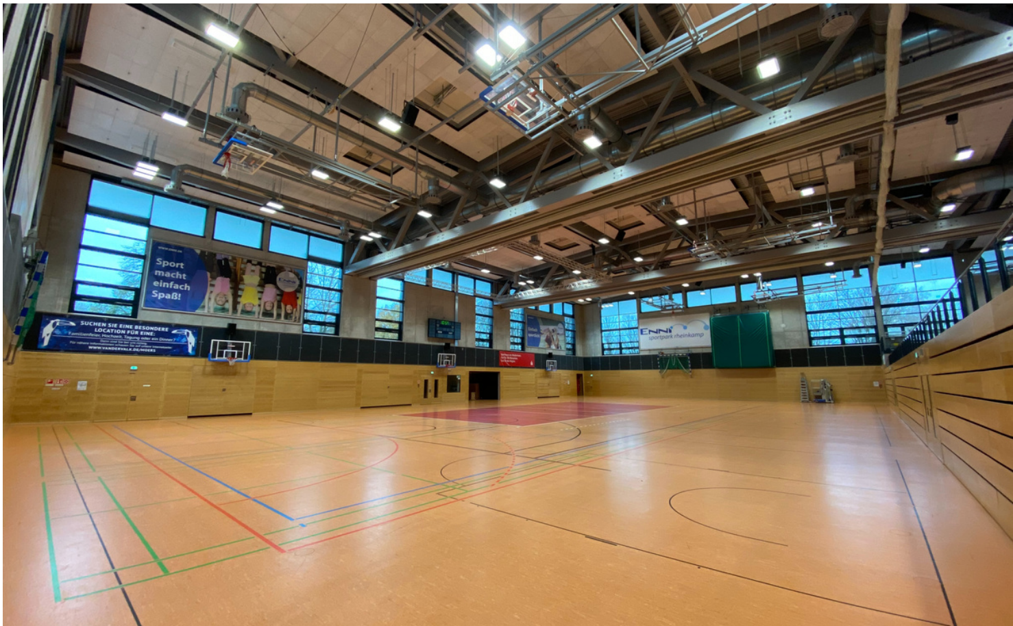
Innen- und Hallenbeleuchtung
