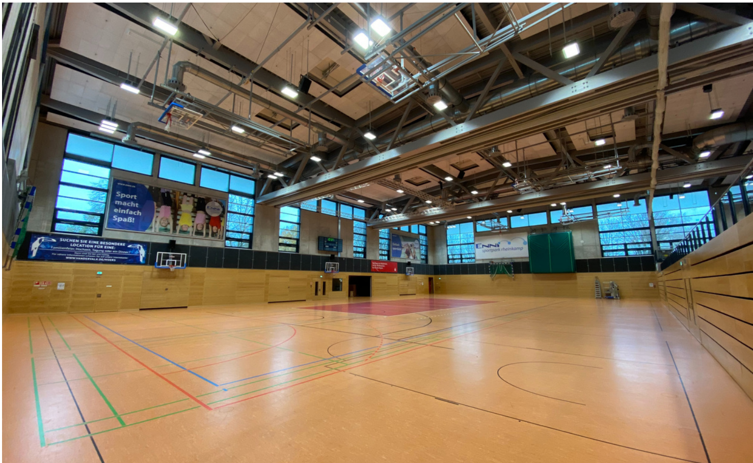
Innen- und Hallenbeleuchtung
