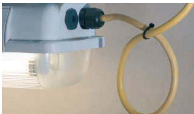
Bild 5: Kabelschleife schützt vor Eindringen des Wassers
